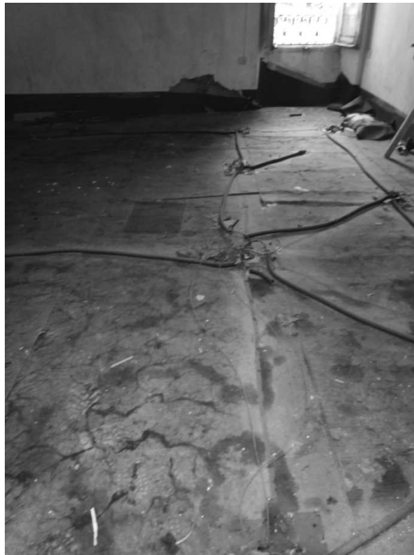
Particolare: guaina con corrugati a vista impianto di illuminazione a servizio del secondo piano.
